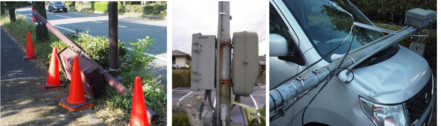
街路灯受電ボックスの倒壊（2018 台風 21 号）・各戸受電ポール根元の腐食に注意
