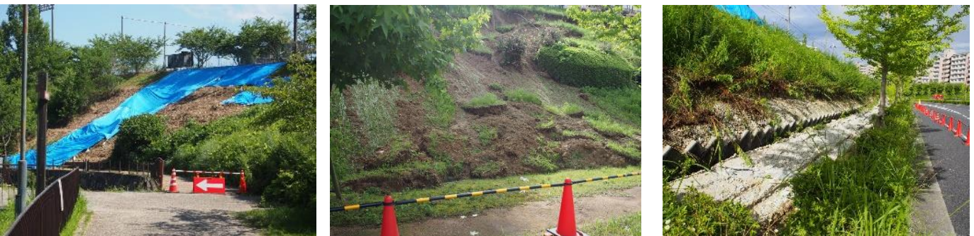
台風 21 号による平谷川遊歩道
